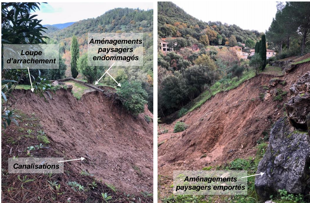
Figure 2 : Vues de côté, en novembre 2019, du glissement de terrain et des aménagements paysagers endommagés (Source : Mairie des Adrets de l'Esterel)
