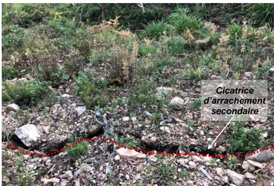
Figure 10 : Cicatrice d'arrachement secondaire visible dans le versant à l'aval de la propriété
