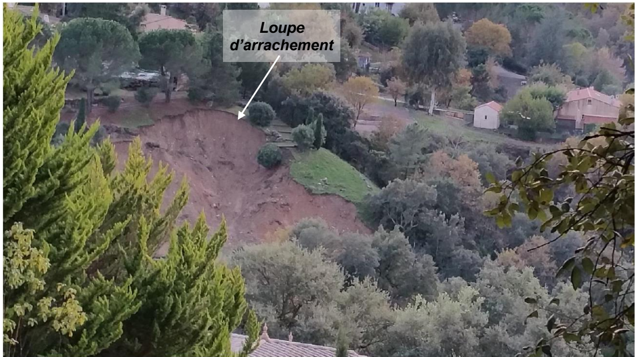
Figure 1 : Vue générale, de face, du glissement de terrain en novembre 2019 (Source : Mairie des Adrets de l'Esterel)
