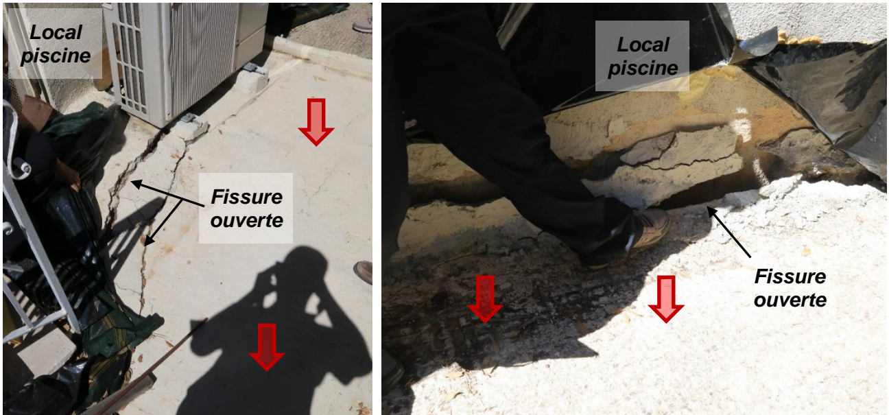
Figure 13 : Fissure ouverte, avec décalage vertical, observée à l'aval du local technique de la piscine
