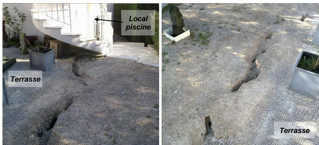
Figure 12 : Fissure ouverte visible au sud de la propriété en novembre 2019 (Source : Mairie des Adrets-de-l'esterel)
