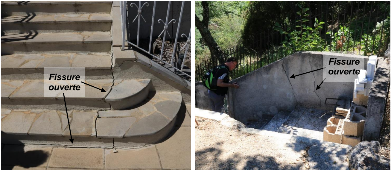
Figure 16 : Escaliers extérieurs fissurés
