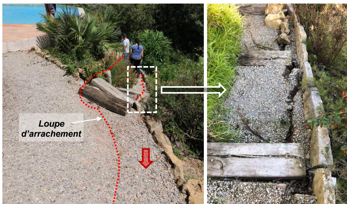
Figure 7 : Loupe d'arrachement visible au pied de la piscine et de l'habitation (à gauche) et cheminement piéton endommagé (à droite, Source : Mairie des Adrets de l'Esterel)
