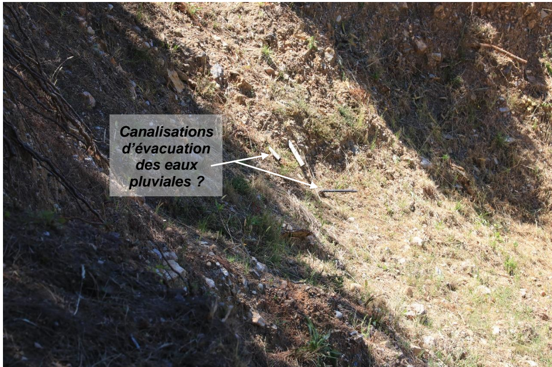
Figure 3 : Canalisations visibles, lors de la visite sur site, au niveau de la loupe d'arrachement
