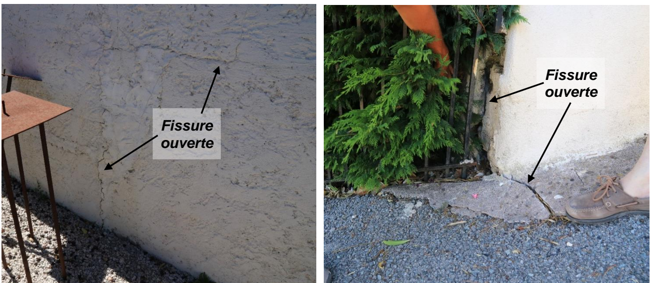
Figure 17 : Fissures ouvertes visibles sur un muret (à gauche) et au niveau de la clôture (à droite)
